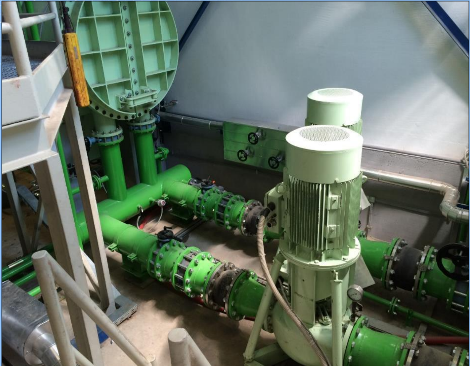
Rashladne pumpe kondenzatora
