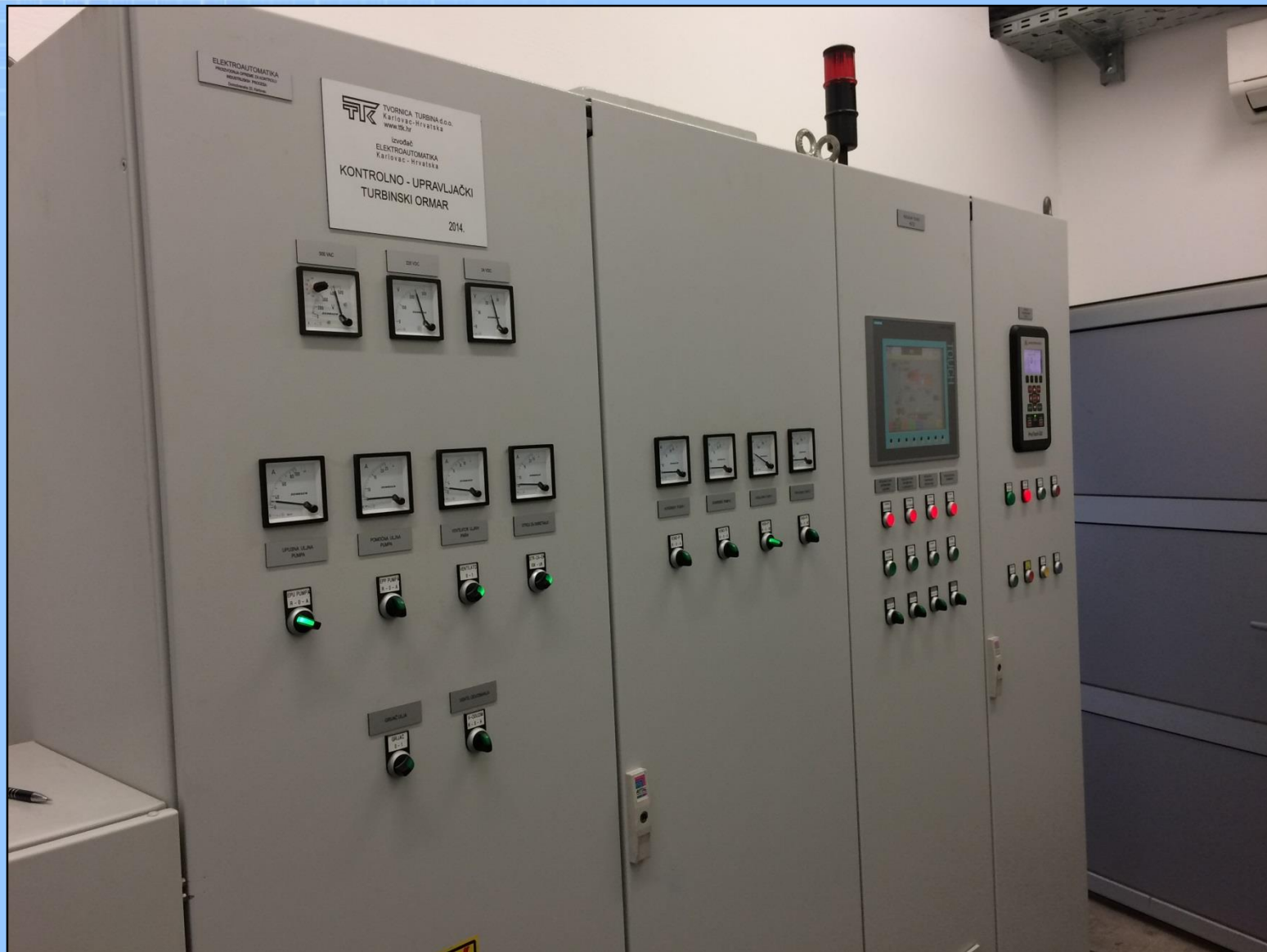
Elektro ormari za upravljanje, regulaciju i zaštitu turbine
