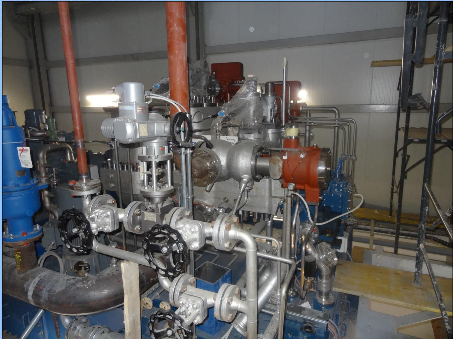
Pogled na dovod pare i servomotore
