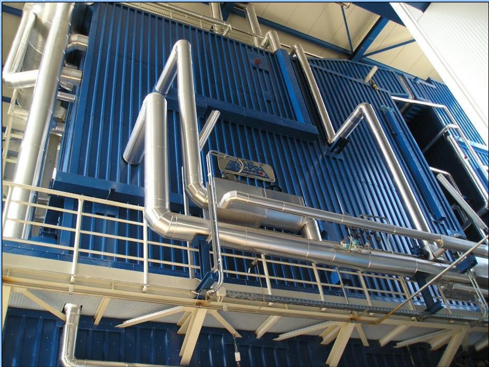
Kogeneracijska energana - pogled na kotlovsko postrojenje
