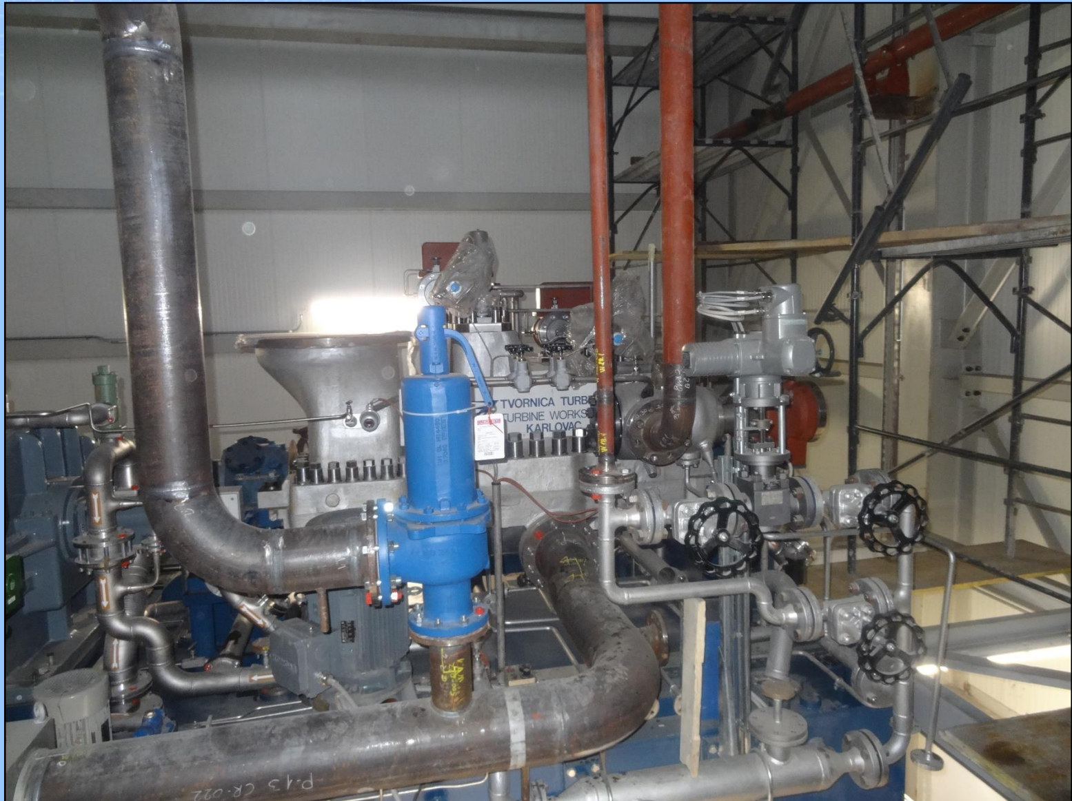
Pogled na dovod pare u turbinu
