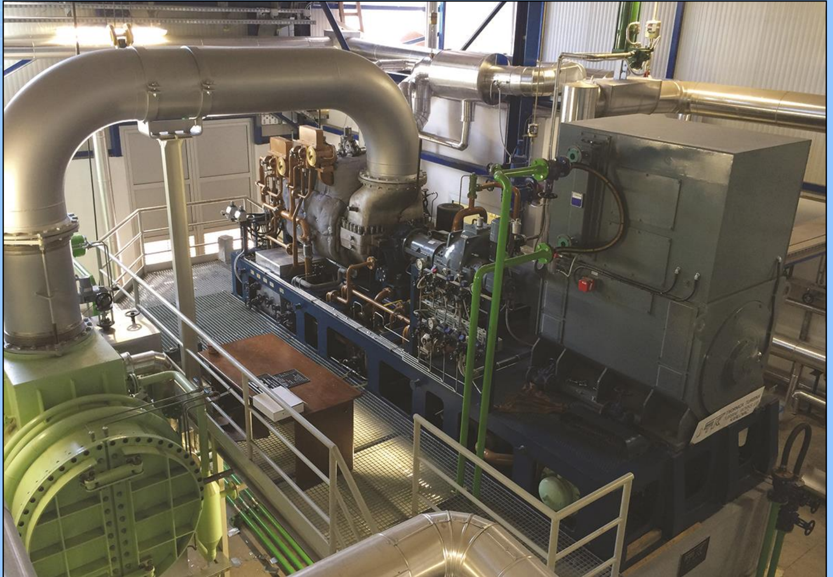
Turbogeneratorski agregat 1,2MWe BE-TO Glina s kondenzatorom s lijeve strane
