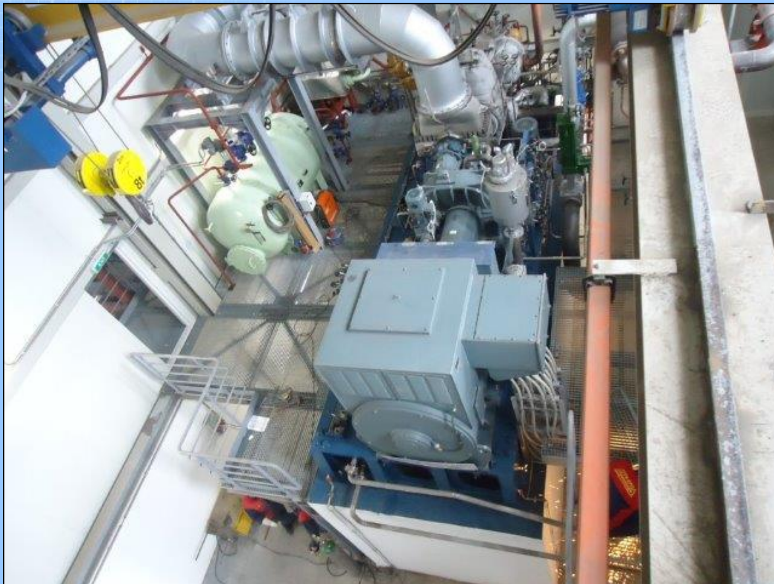
Pogled na strojarnicu
