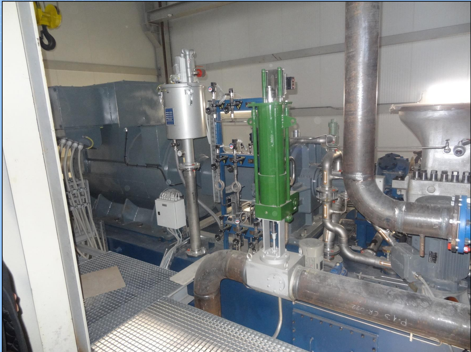
Upravljana nepovratna zaklopka na oduzimanju i generator
